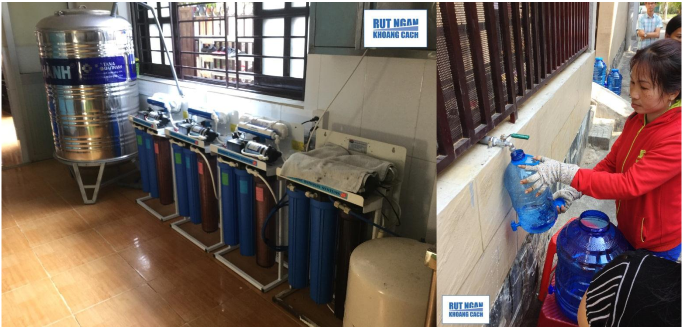
Hệ thống máy lọc nước tại Trung tâm Phát Huy Bình An
